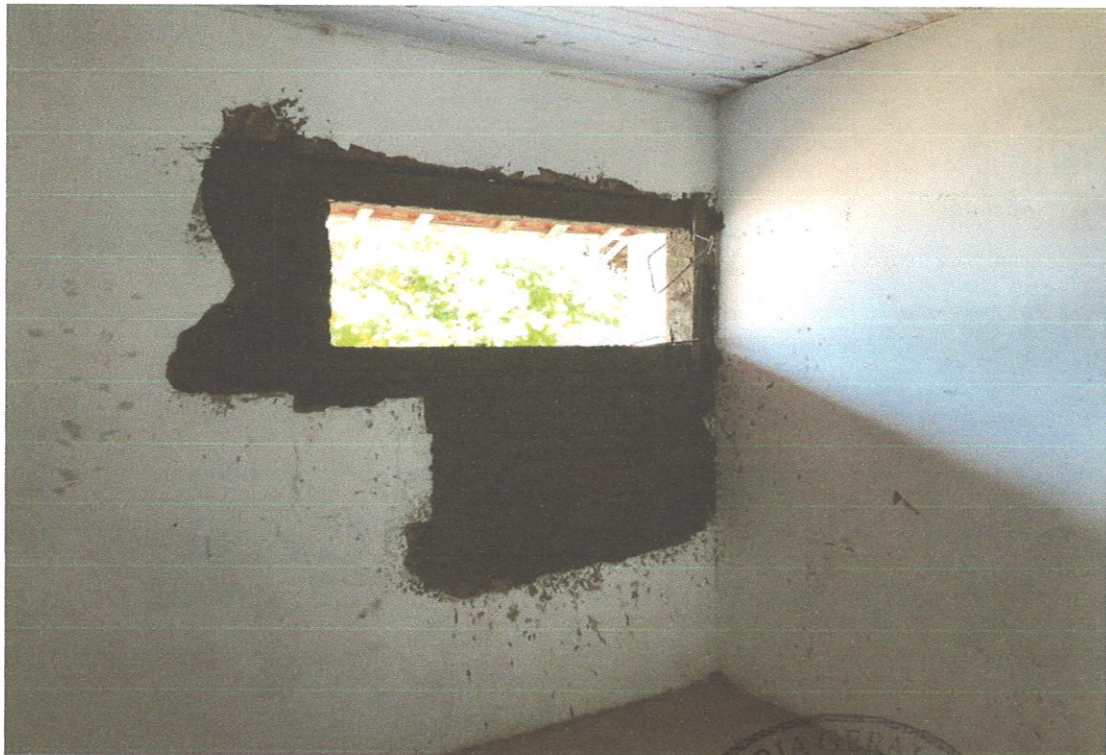
FOTO 21 CHAPISCO NAS PAREDES
